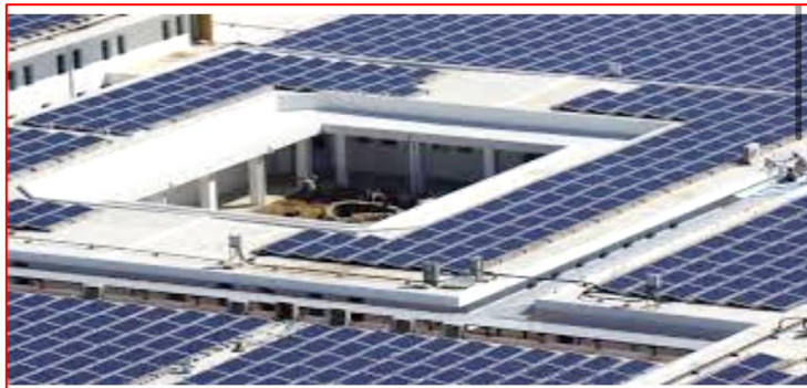
Énergie Solaire. Hôpital Universitaire de Mirebalais.
